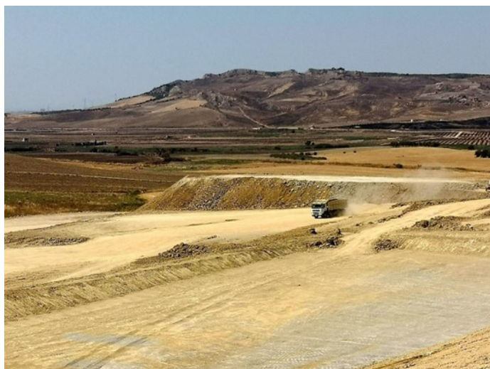
Figura 3: Nuova vasca di abbancamento dei rifiuti.
