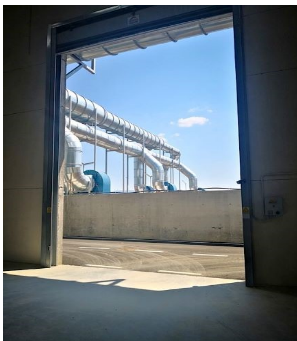
Figura 4 Particolare del nuovo impianto di biostabilizzazione dei rifiuti
